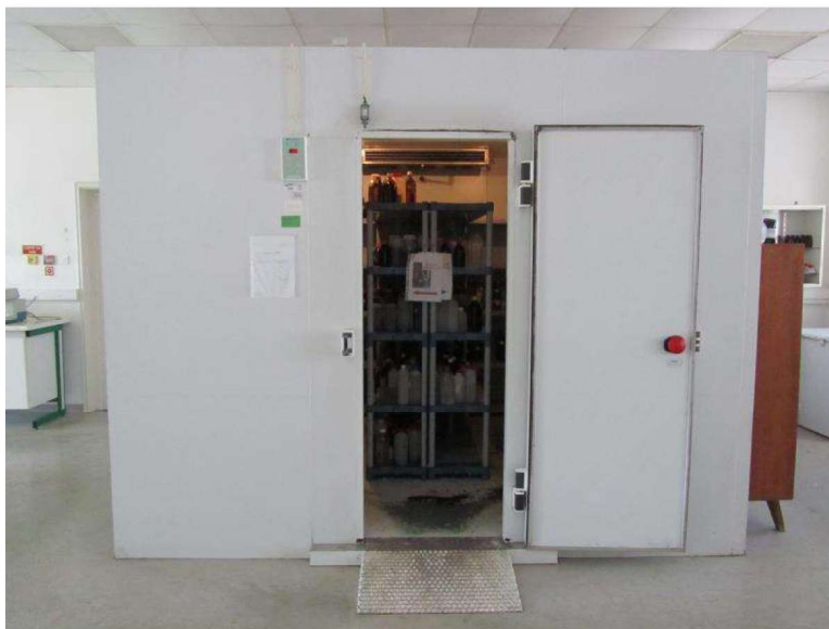
Câmara Frigorífica com capacidade de armazenamento para 3000 amostras
